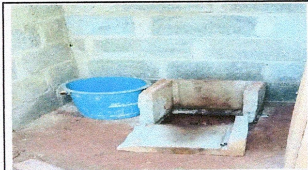
Fotografía 4: letrina quebrada de concreto, se requiere letrina nueva de plastico para niños.
